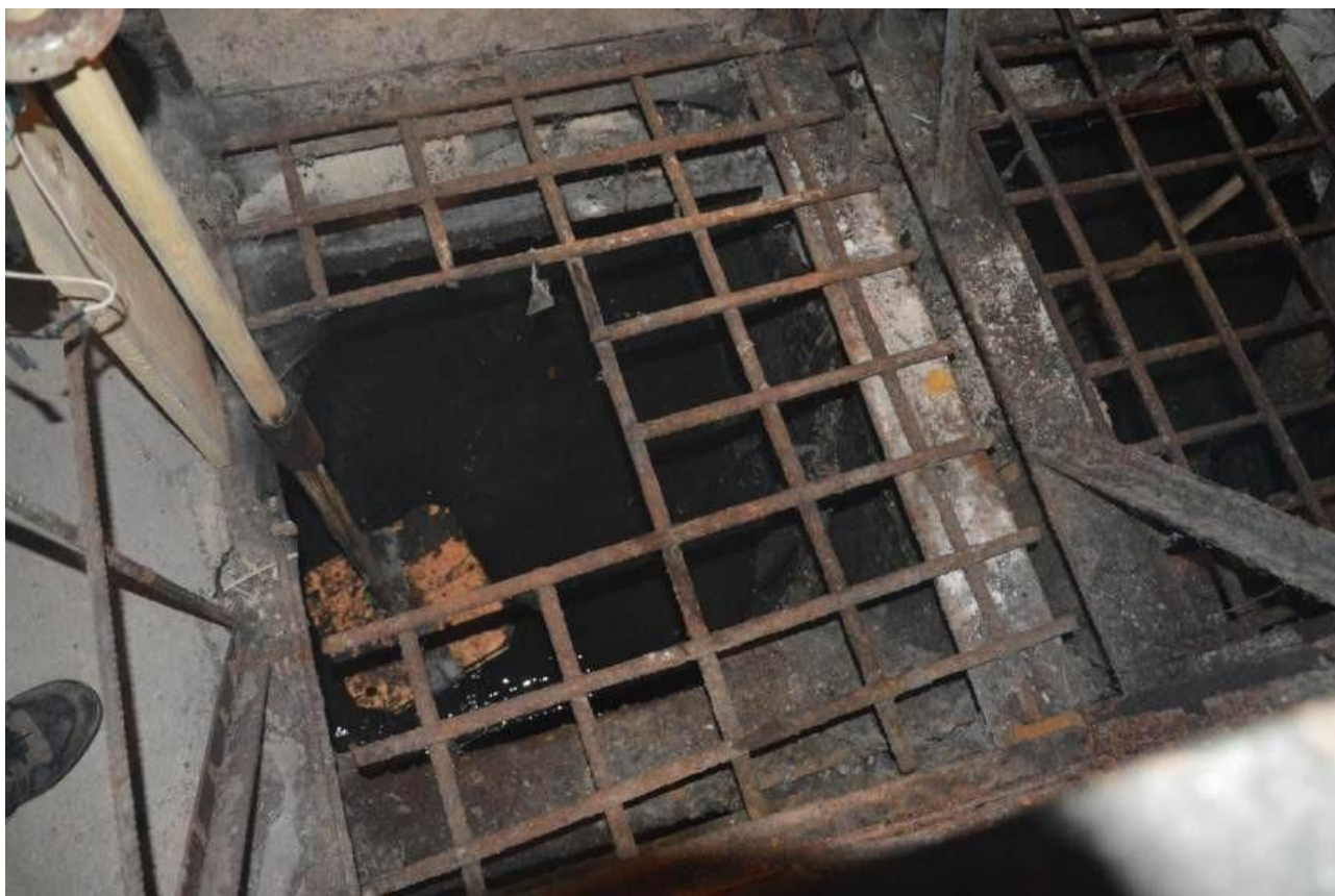
Рисунок 14 – Машинный зал главной канализационной насосной станции
